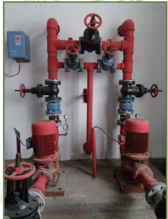
楼宇恒压供水系统
